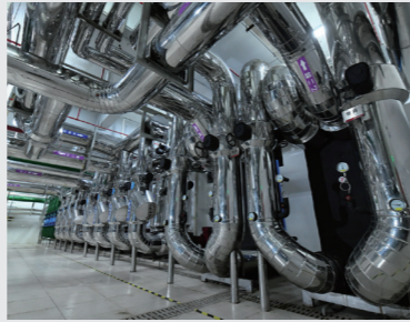
冰蓄冷中央空调
